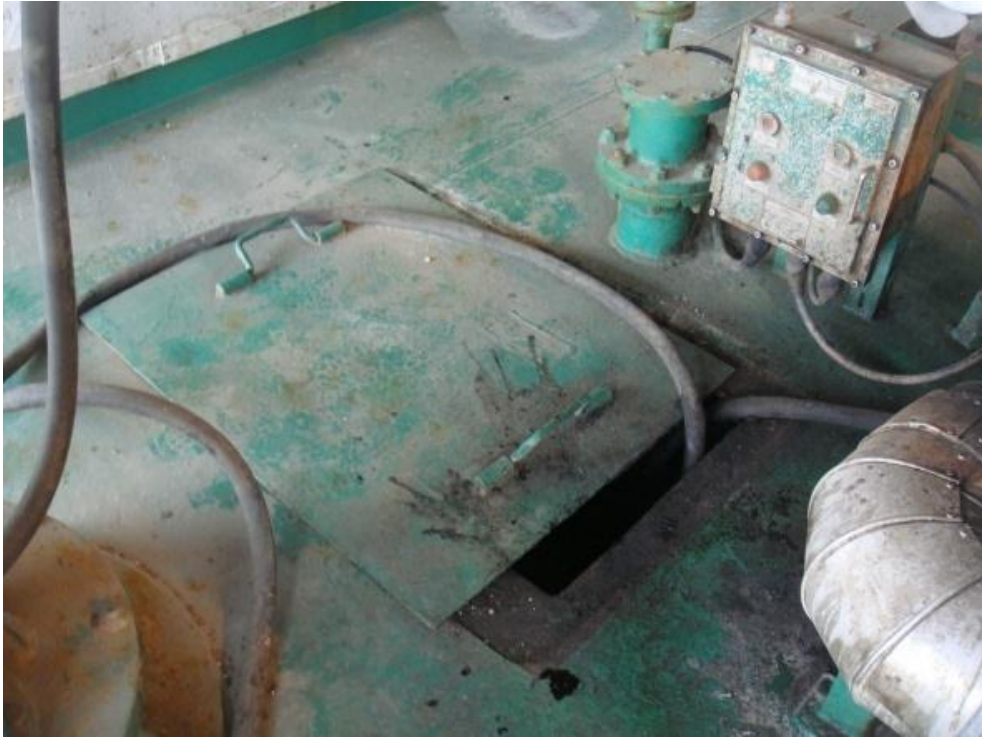
图 2-6 污油池缺少可燃和有毒气体检测装置
