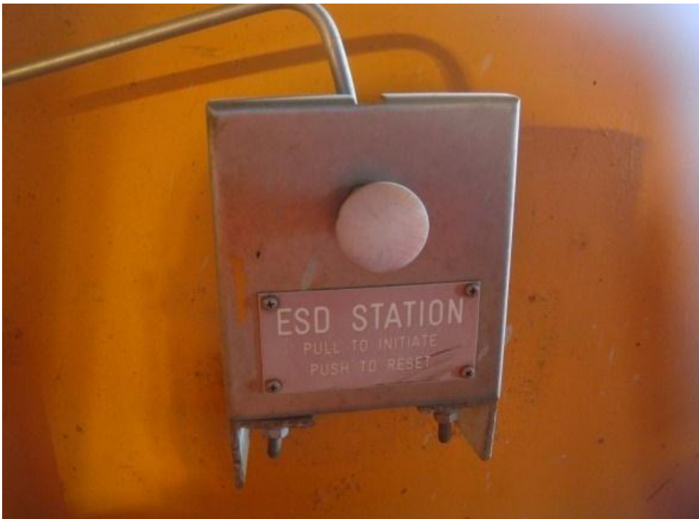
图 2-7 紧急关断阀无防触碰措施
