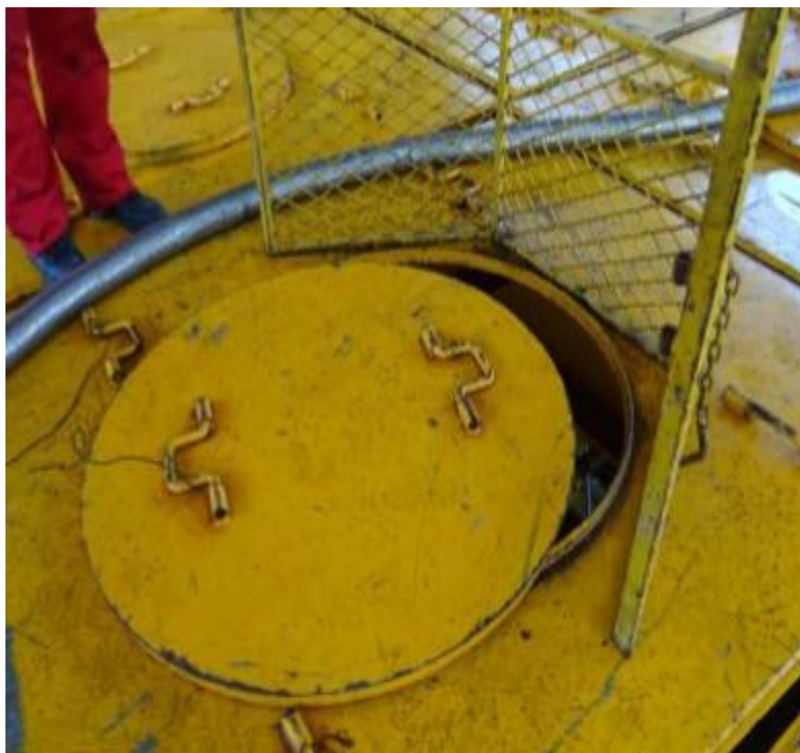
图 2-1 井口区井盖未盖好
