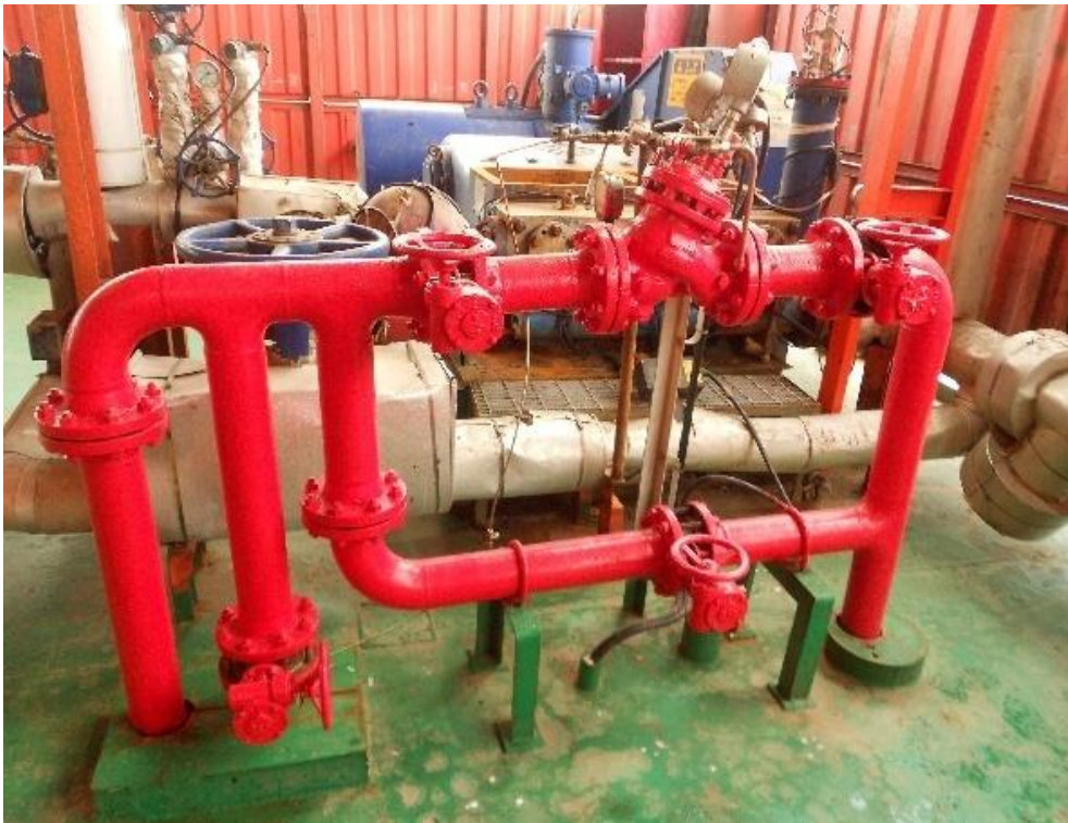
图 2-9 管线上的阀门未悬挂常开常闭标识牌，管线缺少介质名称及流向指示标识
