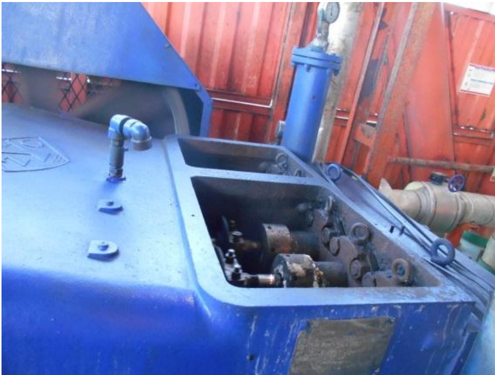
图 2-11 柱塞泵传动轴上方缺少防护盖板
