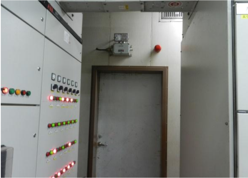
图 2-10 配电间出口未设置安全出口指示标志
