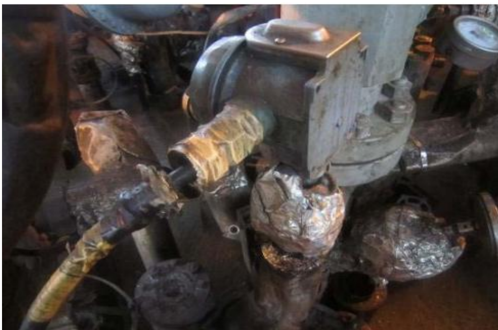
图 2-2 高低压开关线路老化且密封不严
