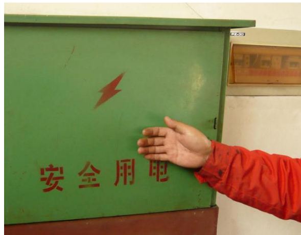
图 2-4 未穿戴绝缘防护用品接触带电设备
