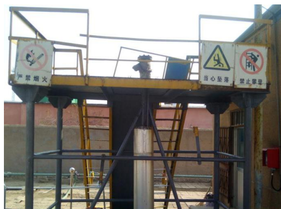
图 2-3 平台、护栏锈蚀、断裂
