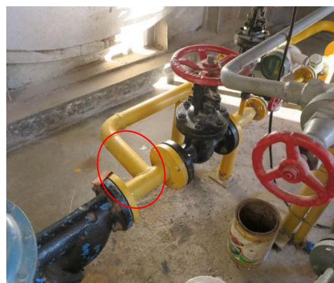
(b) 法兰未等电位跨接
