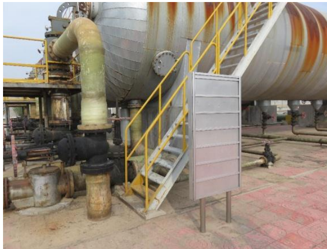
图 2-5 未张贴警示牌、指示牌
